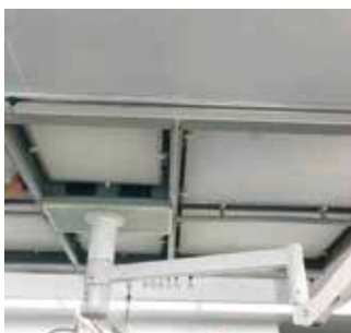
安装在医院的通风系统中
