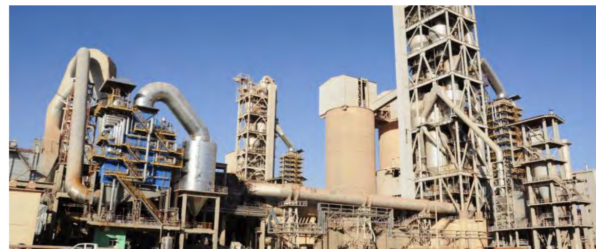
沙特 YCC 余热发电项目
